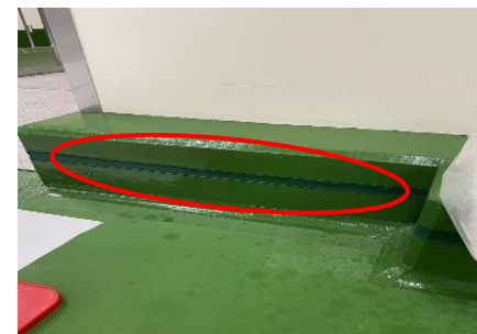
現物の確認不足例（写真－２）
