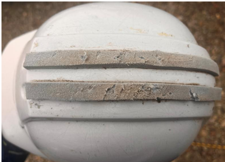
損傷したのり付き角バッカー
